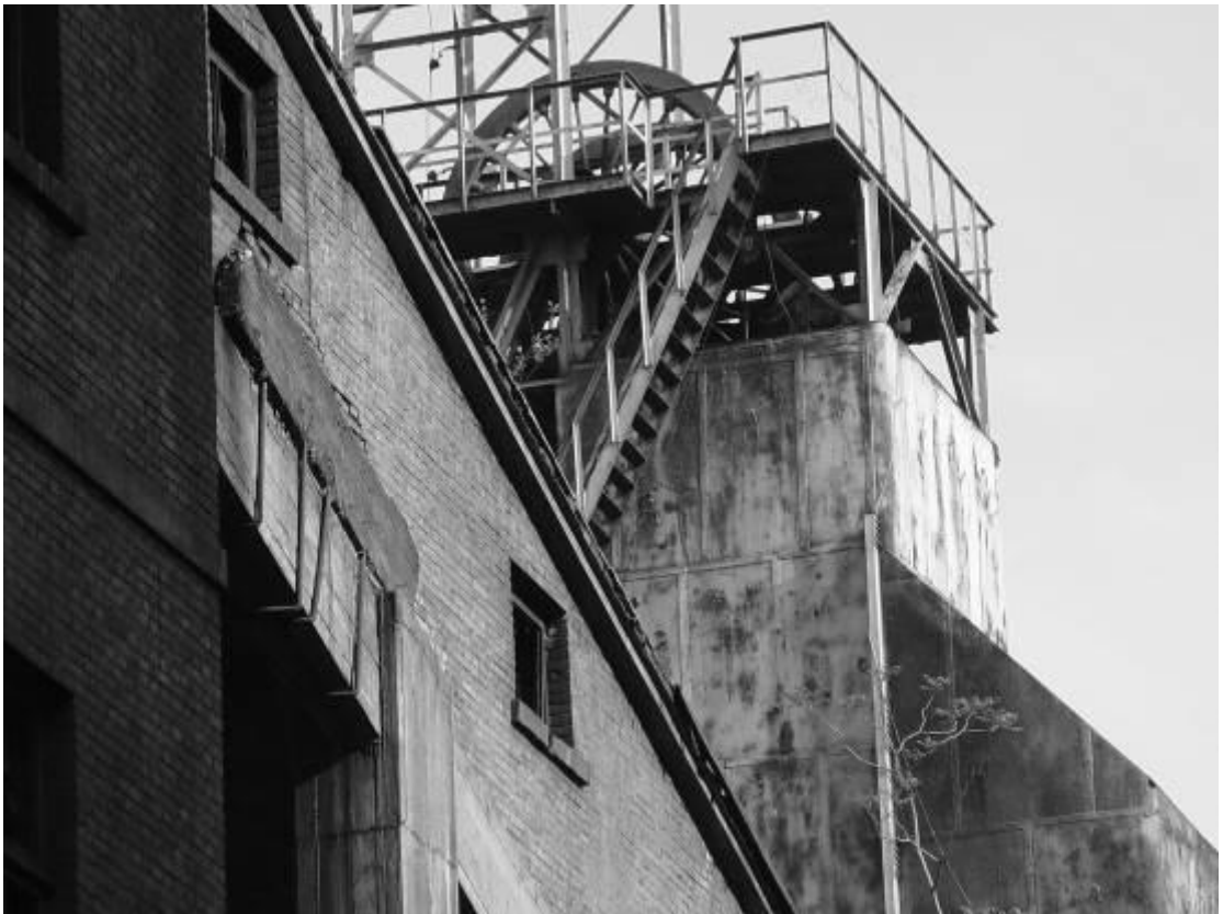
50、三里洞煤矿选煤楼上的天轮
